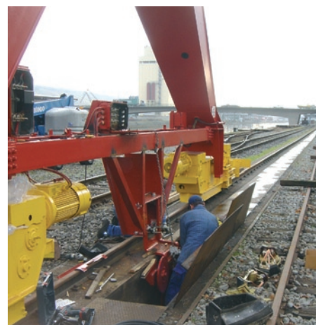
Bild 3: Anbindung der Stromzuführung an den Schleifleitungskanal
