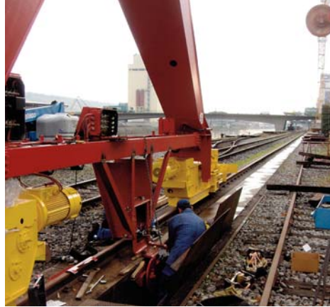
Anbindung des Kranes an die vorhandene Stromzuführung
